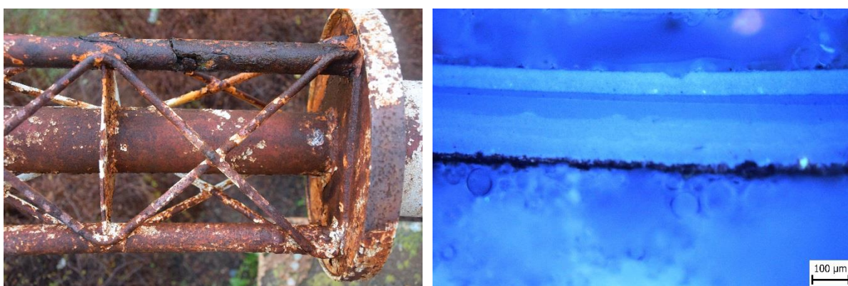
Obr. 11 Plošné i lokální korozní poškození vnějšího kruhového nosníku
