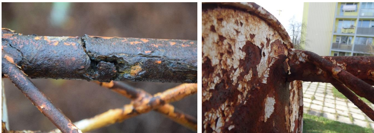
Obr. 10 a, b Dvě místa s prokorodovanými trubkami vnějšího kruhového nosníku
