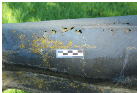
Obr. 15: Biologické znečištění v místech poškození vrchní vrstvy
