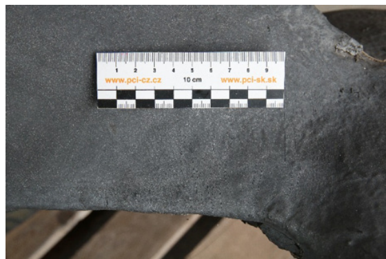
Obr. 6: Vlasové praskliny v povrchové vrstvě laminátu
