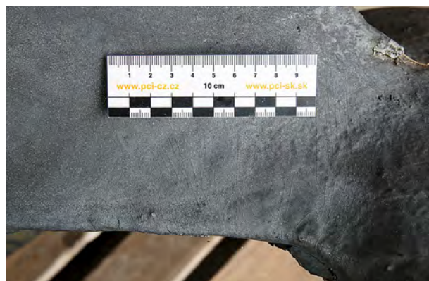
Obr. 1. Vlasové praskliny v povrchové vrstvě laminátu Fig. 1. Hairline cracks in the laminate surface
