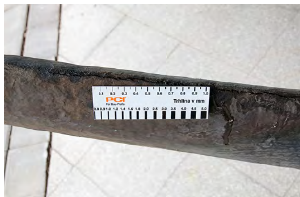
Obr. 2. Prasklina ve vrchní vrstvě laminátu Fig. 2. Crack in the laminate top layer
