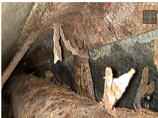
Obr. 14. Pohled na zkorodovanou nosnou konstrukci v prostoru nohy sochy „Rychlost“
