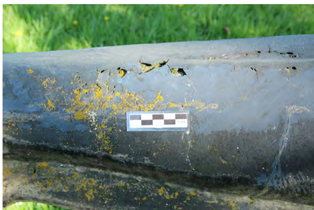
Obr. 7. Biologické znečištění v místech poškození vrchní vrstvy
