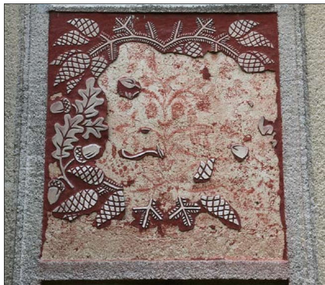
Obr. 24: Lázně Kynžvart, ulice 5. května, sgraffito s florálními motivy nenáratně zničené vlivem povětrnosti. Na obnažené jádrové omítce se nacházejí už jen stopy po původním motivu (foto L. Machačko, 2017).
