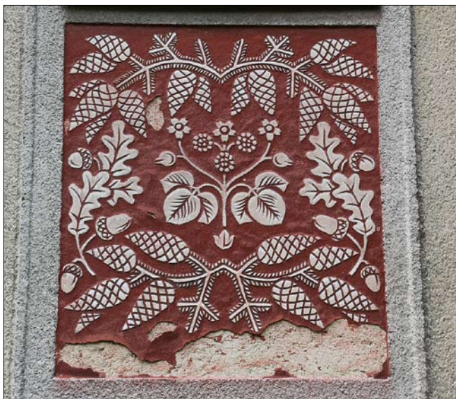
Obr. 23: Lázně Kynžvart (okres Cheb), ulice 5. května, sgraffito s florálními motivy těžce poškozené povětrnostními vlivy – omítkové vrstvy jsou deformovány a oddělují se od jádra (foto L. Machačko, 2017).
