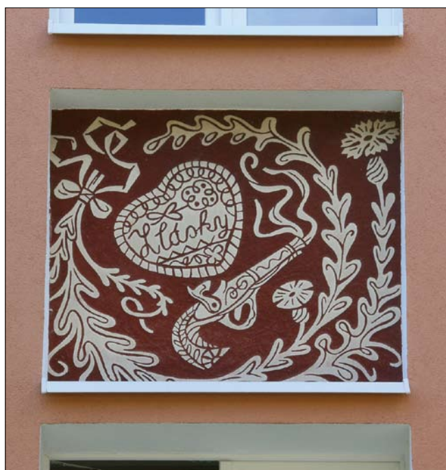
Obr. 22: Pardubice, sídliště Dukla. Fasáda obytného domu z 50. let 20. století po kompletní obnově a zateplení, detail sgrafita. Sgrafito s lidovými motivy akcentujícími místní tradici výroby perníčku bylo sice zachráněno, ale po zateplení fasády je „utopeno“ mezi deskami fasádního polystyrenu (foto L. Machačko, 2017).
